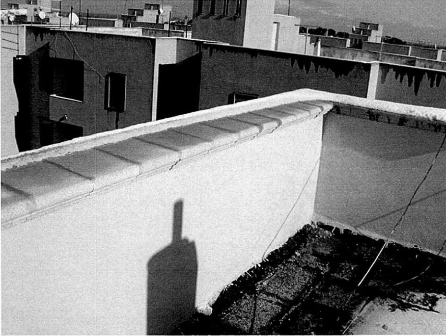
Fotografia 5: Mappette di calcestruzzo sul lastricato solare
