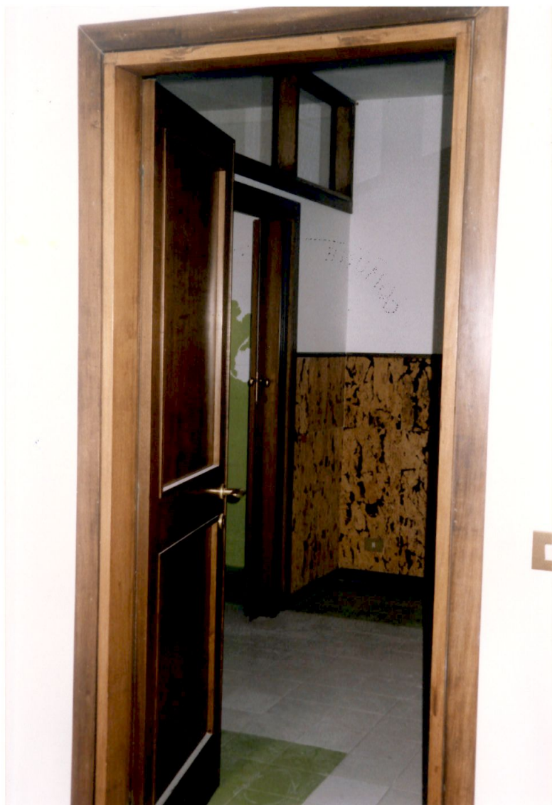
TRAMEZZI INTERNI DA ABBANDONARE
