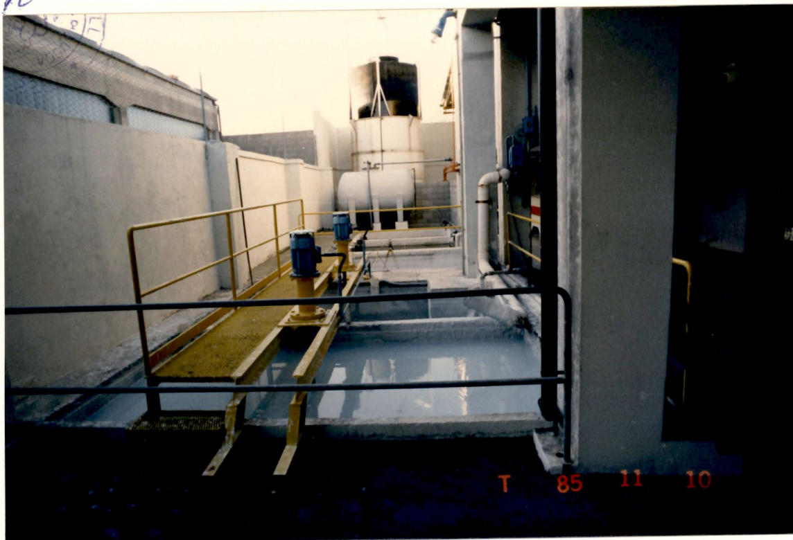
REP. ACETILENE - VA/CHE DECANTAZIONE
