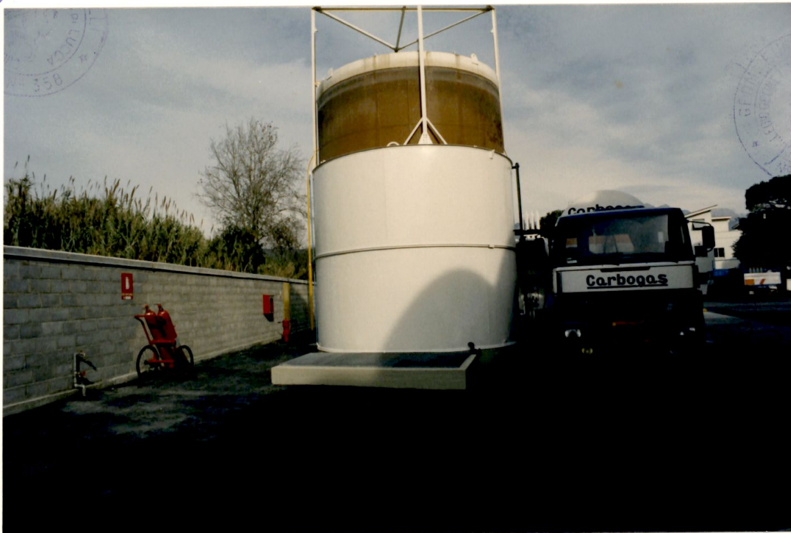
SERBATOIO OSSIGENO LIQUIDO E PARTICOLARE DI MURO DI RECINZIONE
