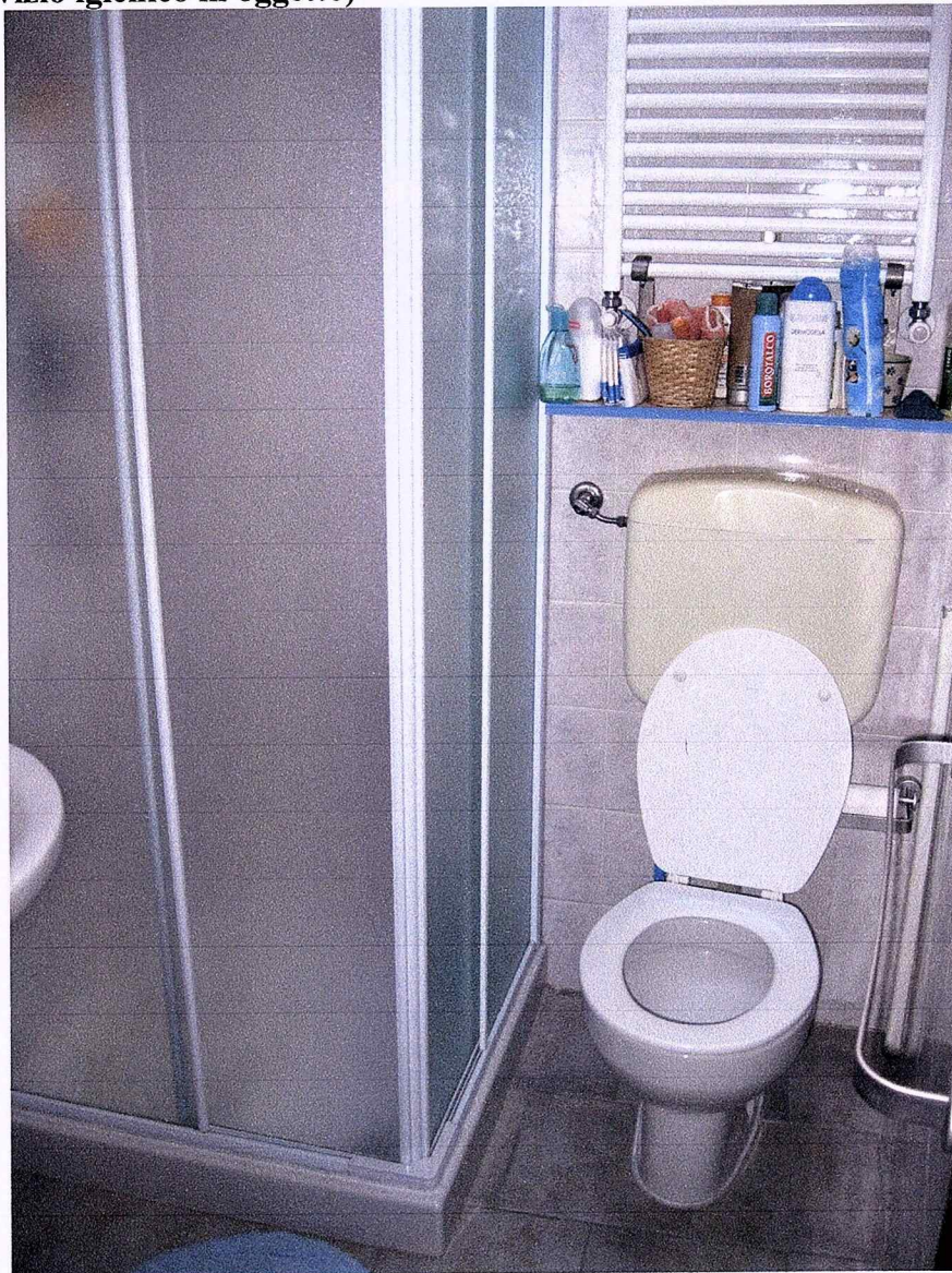
FOTO N° 3(servizio igienico in oggetto)
