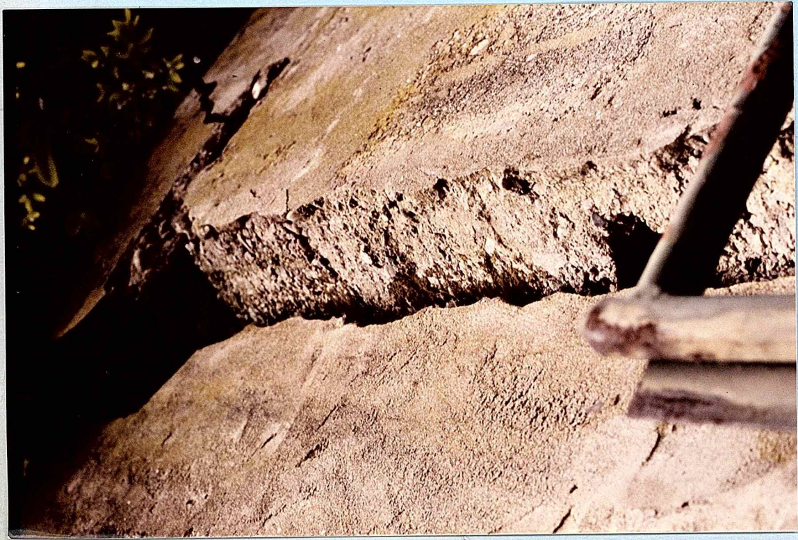
I o LESIONE PASSANTE LATO CARRARA (m. 1.30 del filo strada)
