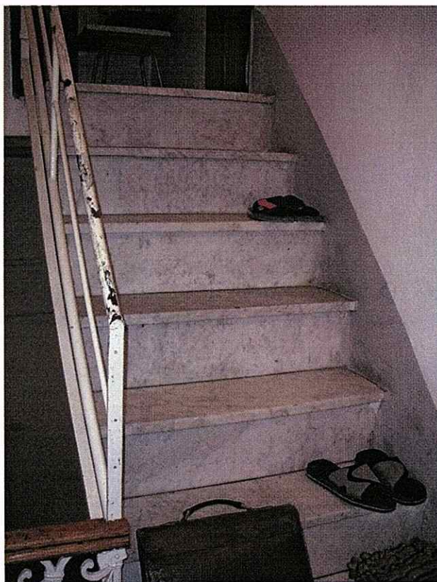
Foto 2 – Scala al Rip. (elemento non originale)
