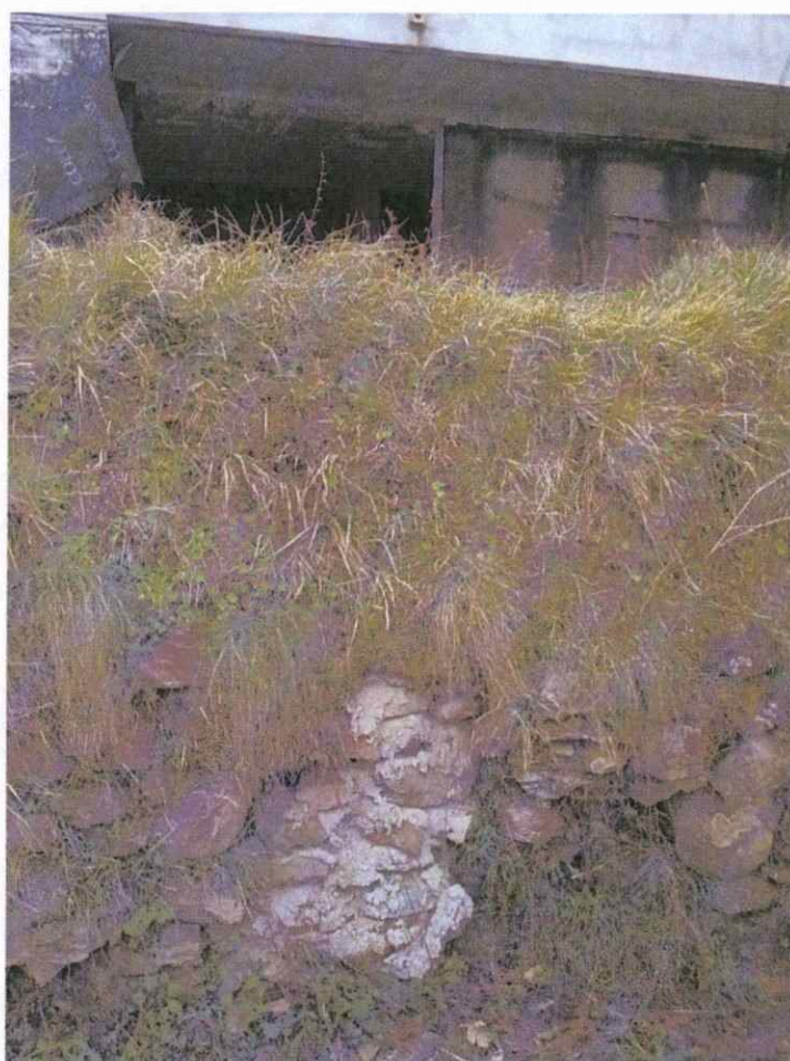
Foto3 – Dettaglio del muro a secco in parte cementato.
