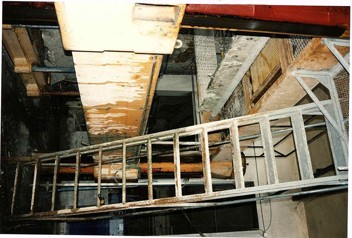
TELAIO DA SOSTTUIRE
