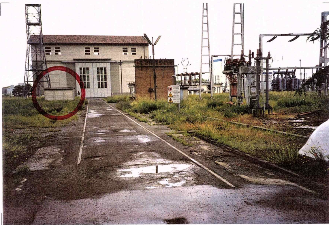
BOX PREFABBRICATO GRUPPO ELETTROGENO
