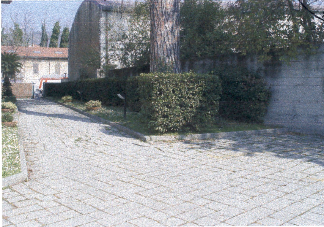
Foto 2 – Vista del vialetto dissestato, dal parcheggio verso l'ingresso
