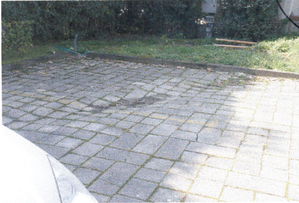
Foto 3 – Il particolare evidenzia il dissesto della pavimentazione nell'area parcheggio
