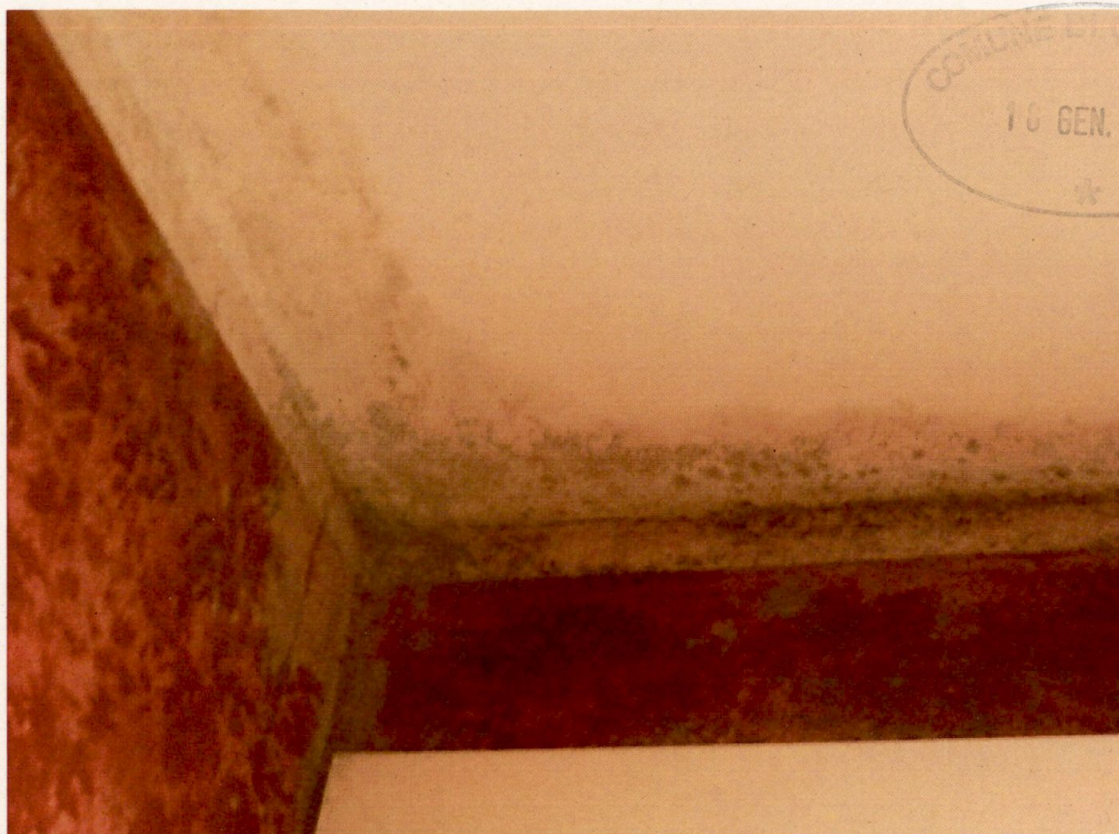
efflorescenze e muffe
