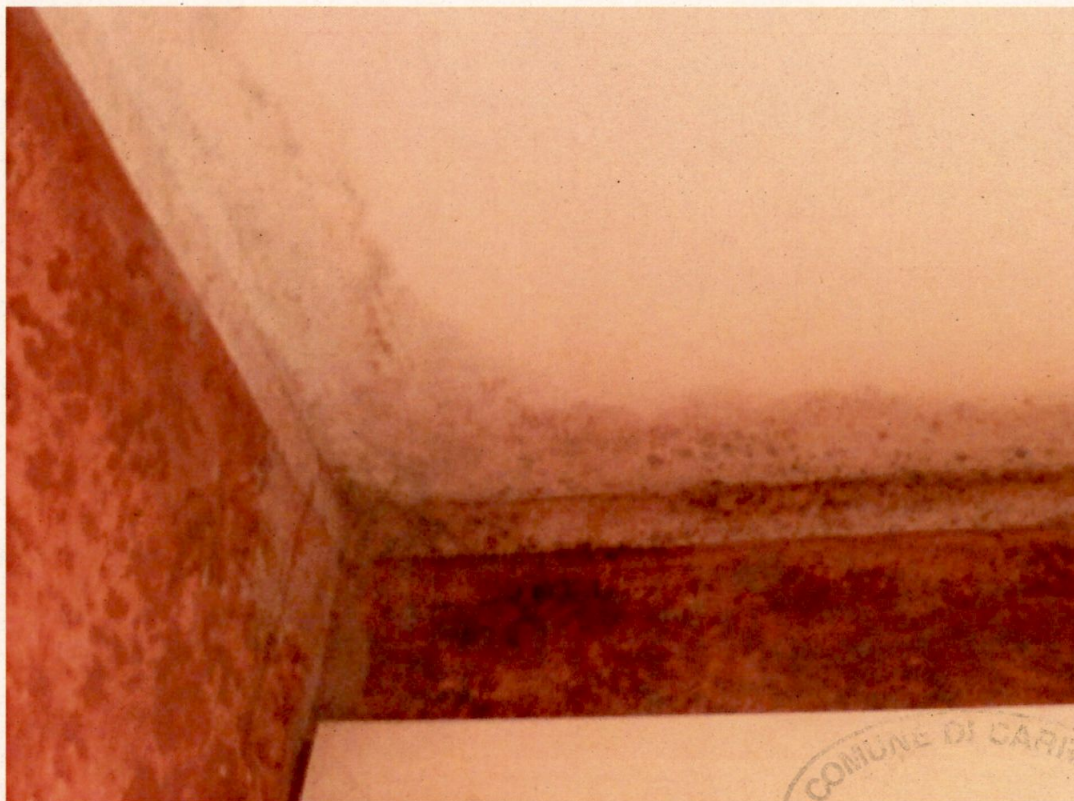
efflorescenze e muffe
