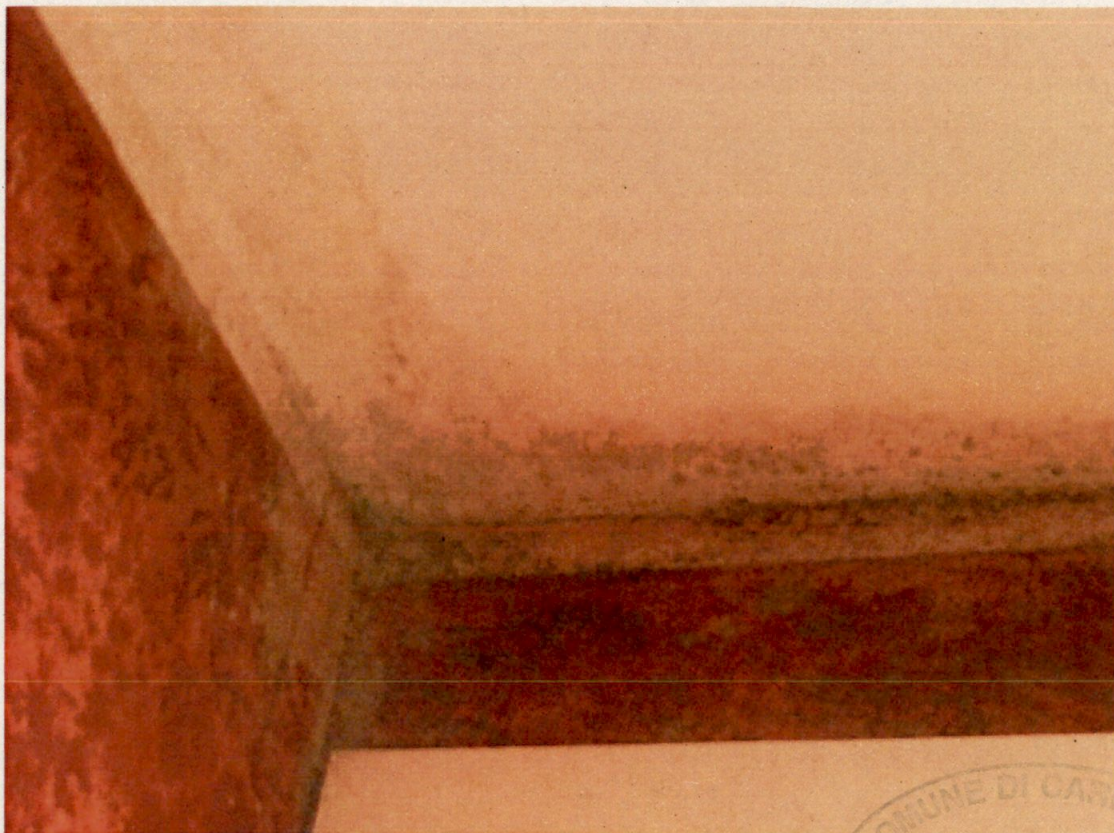
efflorescenze e muffe
