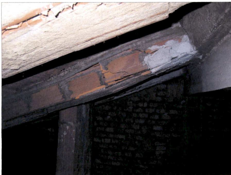
FOTO N. 3-5390: VISTA TRAVI DA SOSTITUIRE LATO NORD
