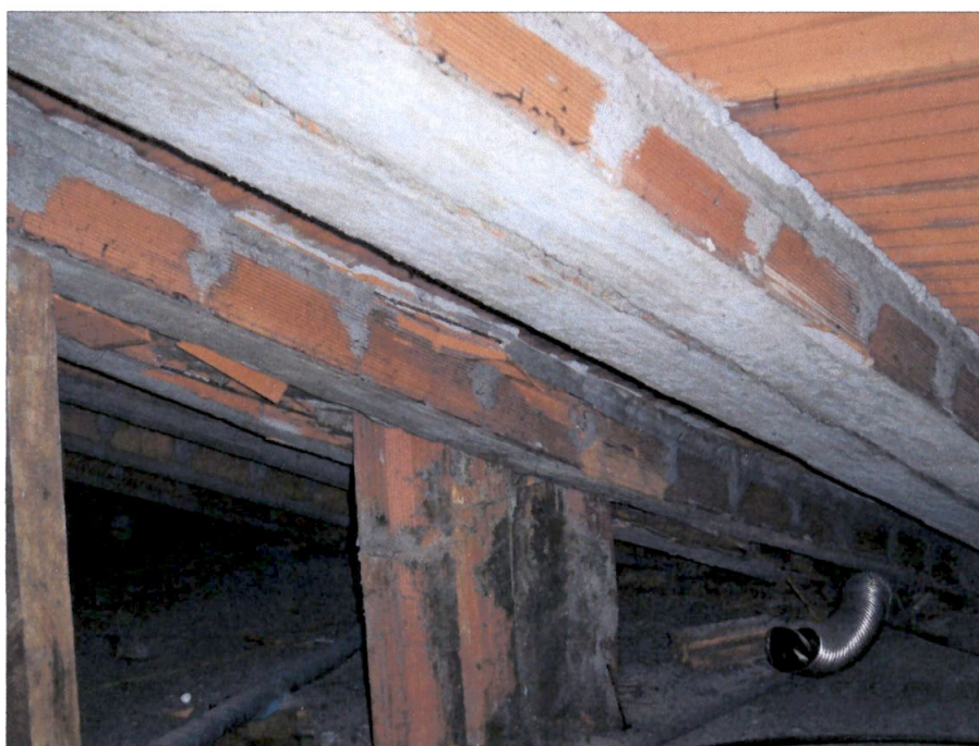
FOTO N. 5-100_7928: VISTA TRAVI DA SOSTITUIRE LATO SUD
