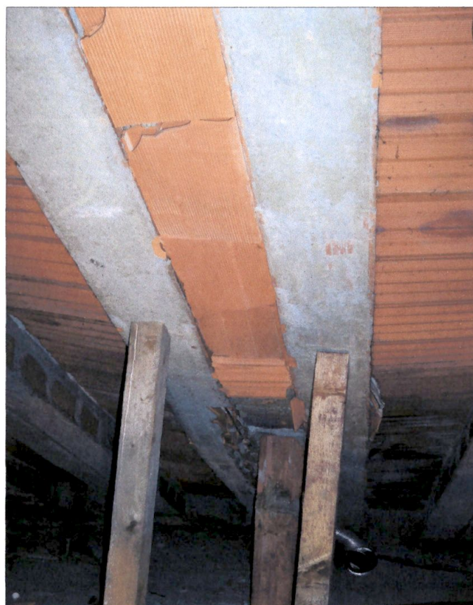
FOTO N. 9-100_7929: VISTA TRAVI DA SOSTITUIRE LATO SUD
