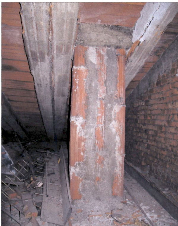
FOTO N. 2-5391: VISTA TRAVI DA SOSTITUIRE LATO NORD
