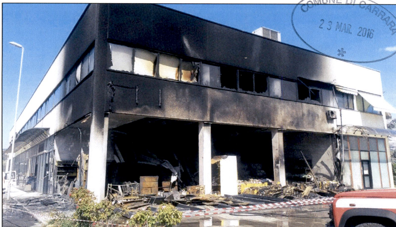
Foto 3: Prospetto dell'edificio successivo all'incendio del 29 settembre 2015
