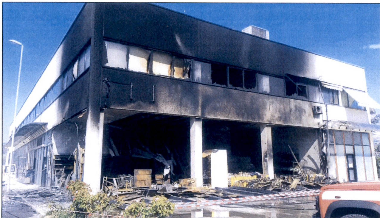
Foto 3: Prospetto dell'edificio successivo all'incendio del 29 settembre 2015
